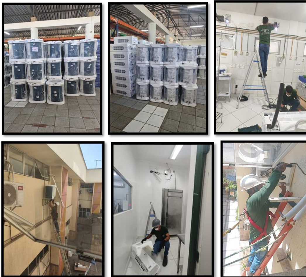
Figura 37 - Aparelhos de Ar-condicionados adquiridos em 2024
