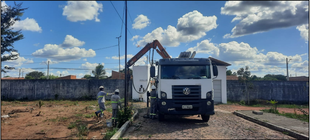
Imagens 38, 39 e 40: Iluminação do cemitério da Camboa.
